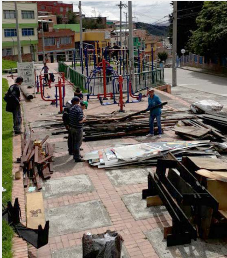
Figura 2: Clasificación de materiales durante el desmontaje de la Casa del Viento. Fuente: Elaboración propia, 2017.
