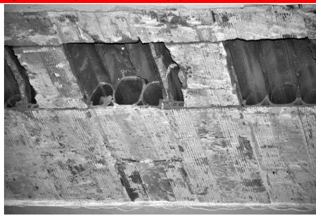
Figura 1. Cata inferior realizada en el forjado. Elaboración propia, 2013.
